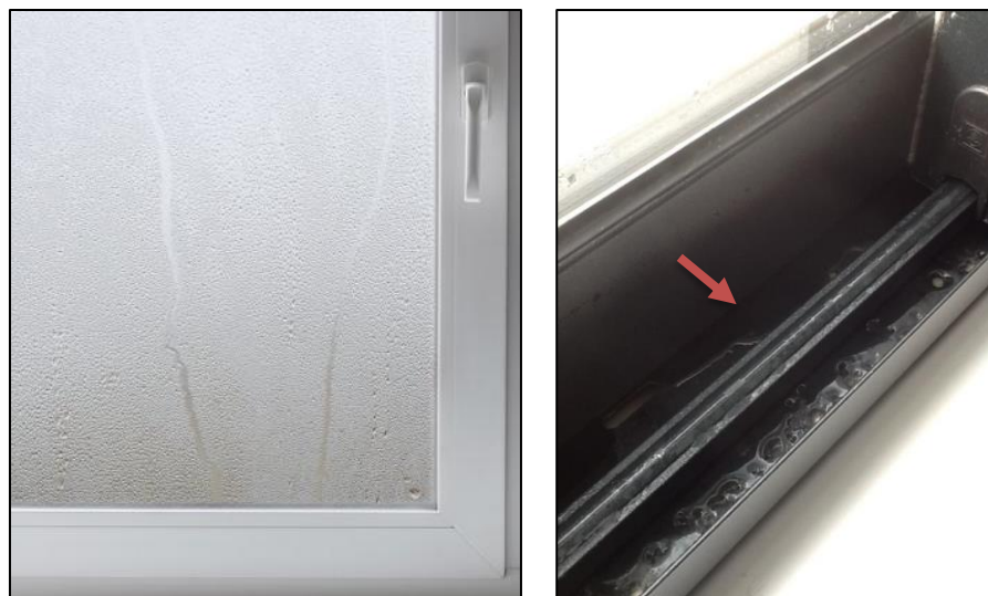
Figura 32 - Condensação de água no interior dos caixilhos.
