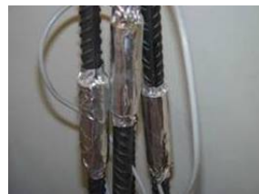
c) Deformação nas armaduras
