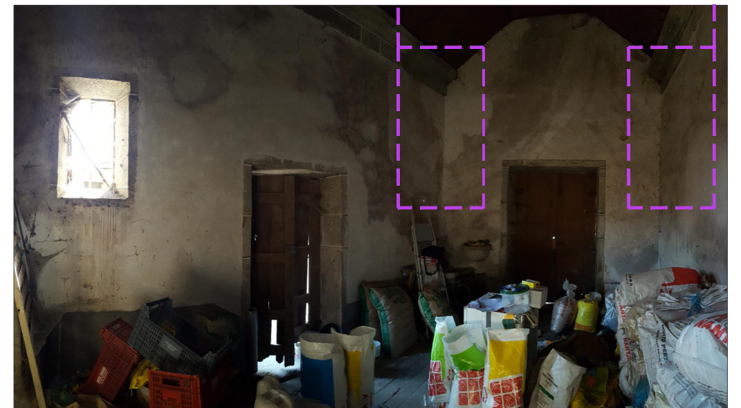
PANORÂMICA DO INTERIOR DA CAPELA (PAREDES CAÍDAS)
