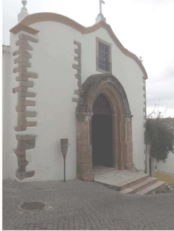
Figura 37 - Alçado Poente onde está presente o portal identificado como pertencendo ao século XIII, e como elemento sobrevivente até aos dias de hoje.
