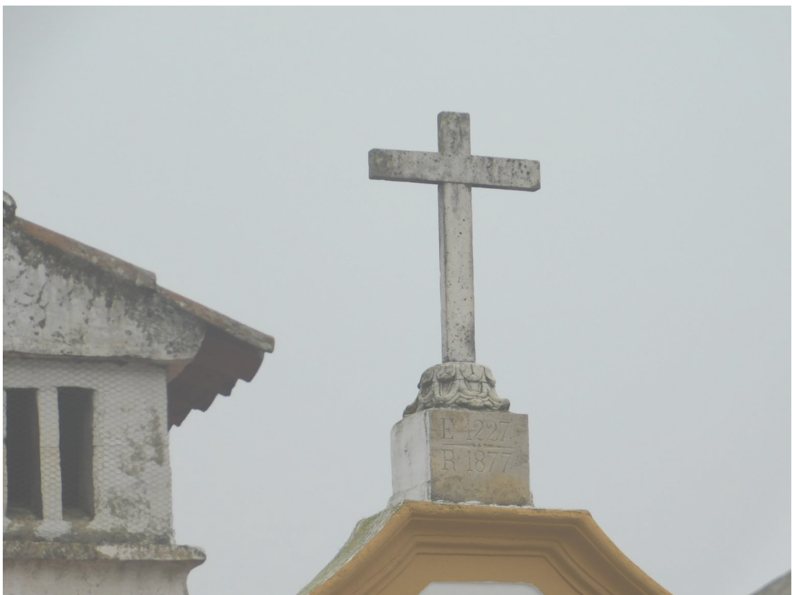
Figura 34 - Fotografia da cruz que coroa a fachada principal e na qual está inscrito o seguinte: E 1227 R 1877
