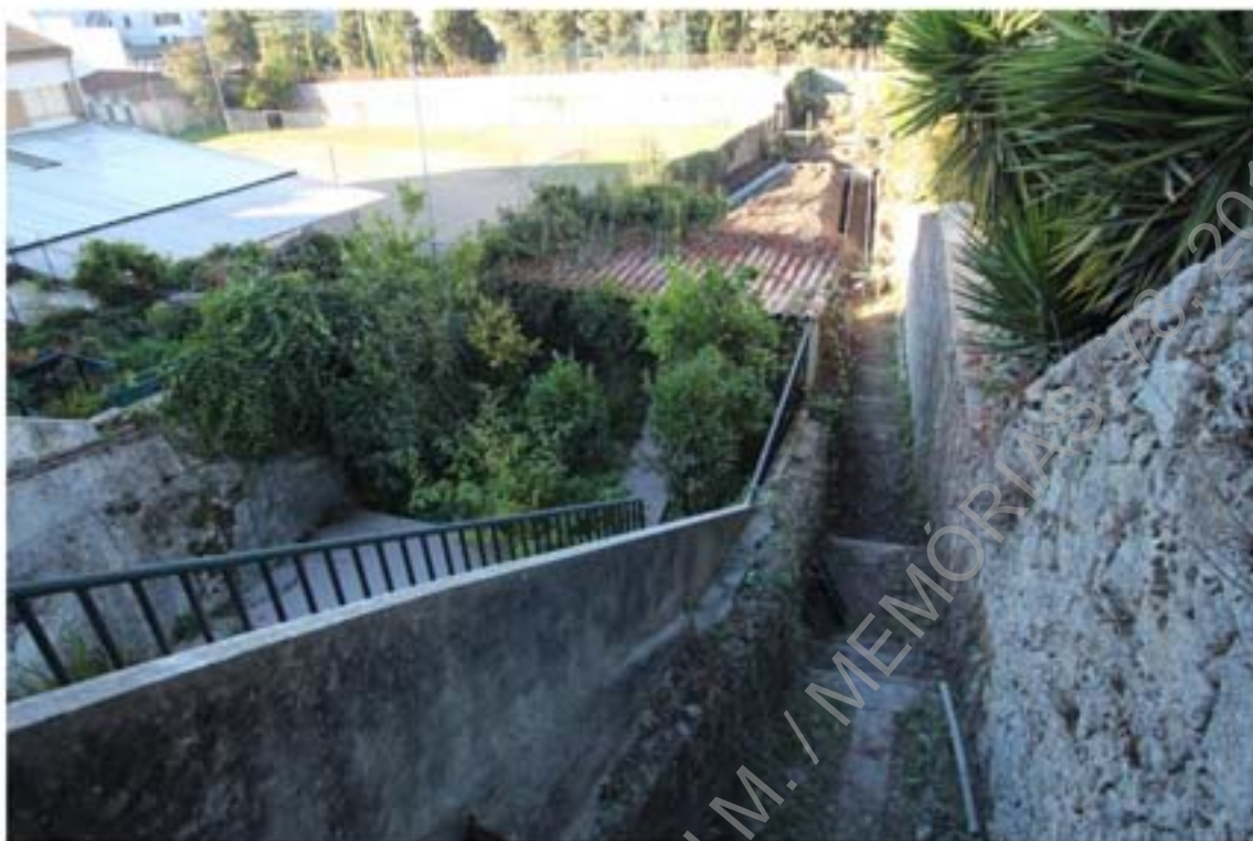
Foto 3 – Escadas de acesso aos jardins traseiros, vista a partir da área 2 (UE0041).
