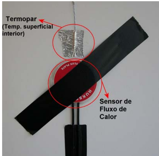
Figura All.1 – Sensor de fluxo de calor e temperatura superficial interior instalados na Célula de Teste Convencional.
