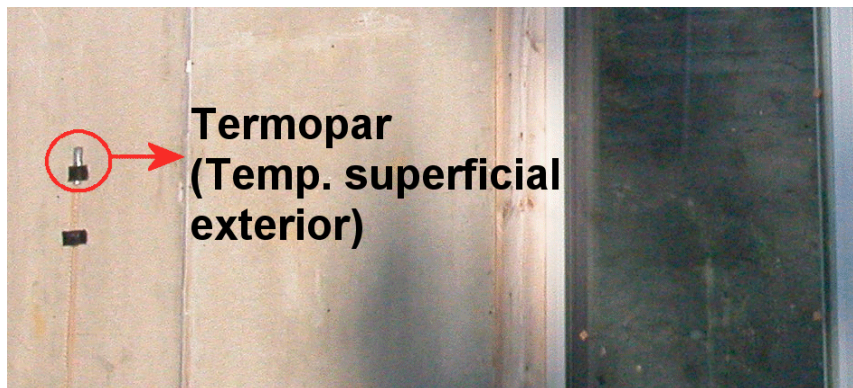
Figura All.2 – Sensor de temperatura superficial exterior instalado na Célula de Teste não Convencional.
