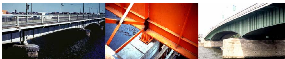
Figura 2.10 Obras de arte com vigas metálicas soldadas de alma esbelta e inércia variável.
