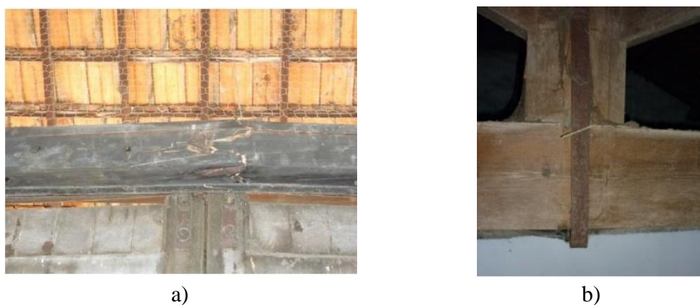
Figura 2.3: Danos e patologias: a) rotura de elemento devido à colocação de uma cavilha; b) deformação de uma asna com consequência na ligação entre pendural e linha (adaptado de Branco e Sousa, 2014).
