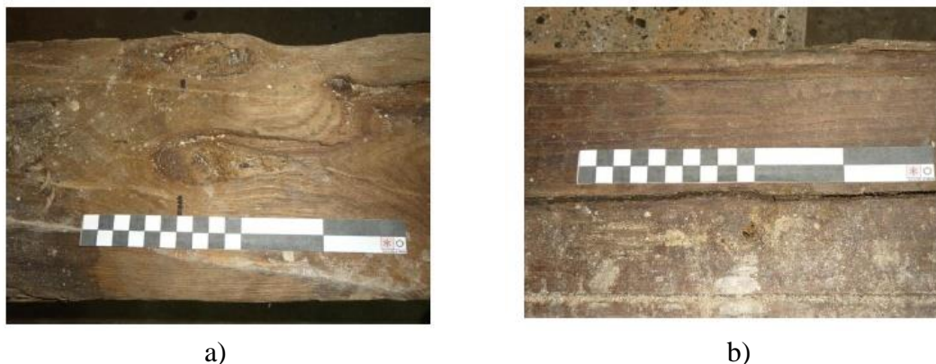
Figura 2.2: Inspeção e medição de defeitos: a) nós; b) fissura ao longo do fio (adaptado de Branco e Sousa, 2014).
