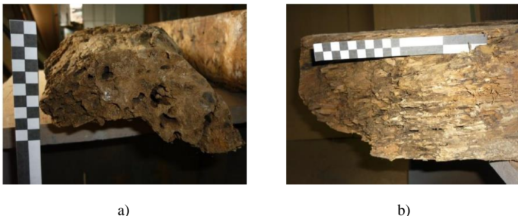
Figura 2.4: Exemplos de degradação biológica de vigas de madeira (adaptado de Branco e Sousa, 2014).
