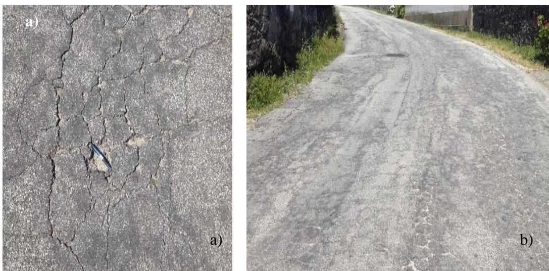
Figura 53 - Patologias na EN302-1; a) Pele crocodilo Nível 3; Desagregação superficial Nível 3; Ninhos Nível 2; Tapagem de covas e reparações Nível 2 (Distância 380m-442m); b) Pele crocodilo Nível 3; Desagregação superficial Nível 2 (Distância: 804m-843m)
