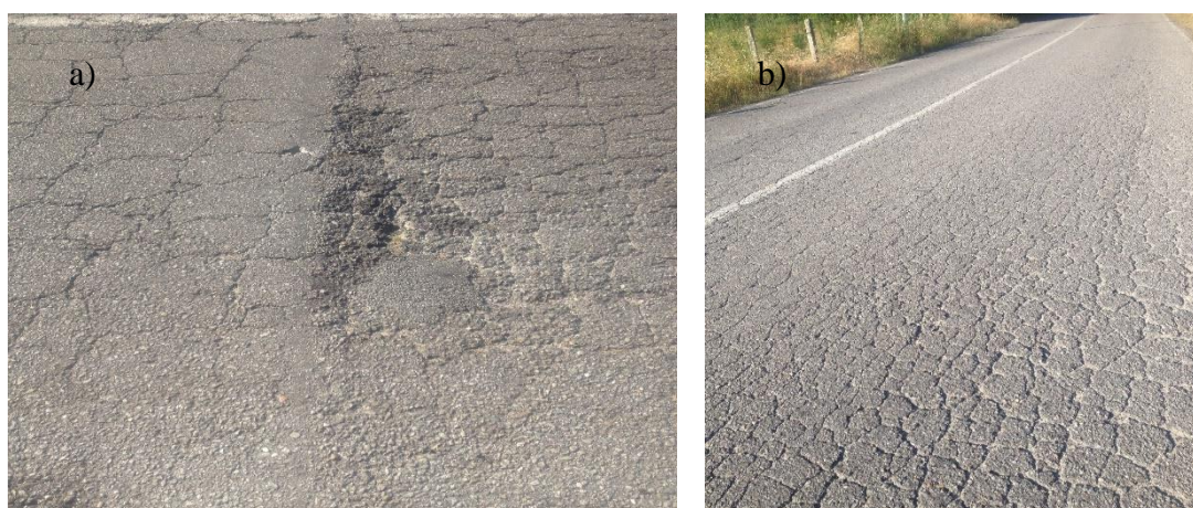
Figura 30 - Patologias no pavimento Avenida do Atlântico – Acesso Amorosa; a) Pele crocodilo Nível 2; Desagregação superficial Nível 3; Deformação localizada Nível 3 (Distância 394m); b) Pele crocodilo Nível 3; Deformação localizada Nível 2 (Distância: 840m-920m)
