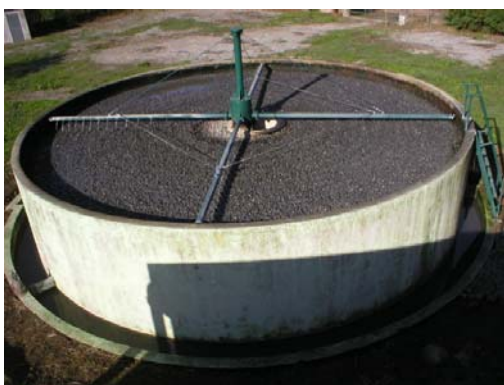
Figura 7 – Tanque percolador da ETAR de Ponte de Lima (vista superior).
