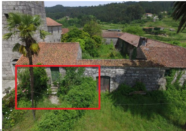
Figura 4.22: Fachada principal do Mosteiro de Mancelos coberta por vegetação
