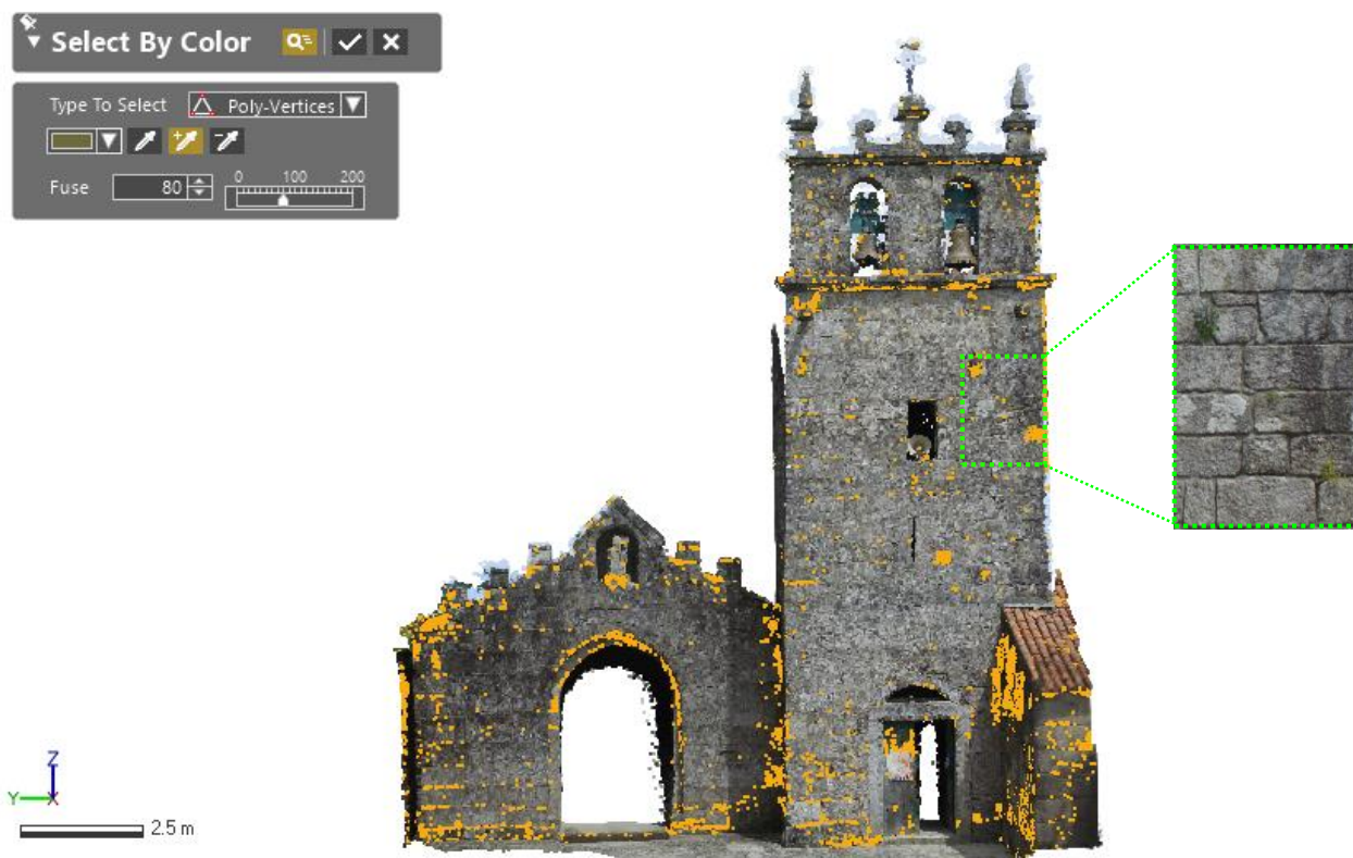
Figura 4.13: Identificação de colonização biológica na fachada principal do Mosteiro de Mancelos
