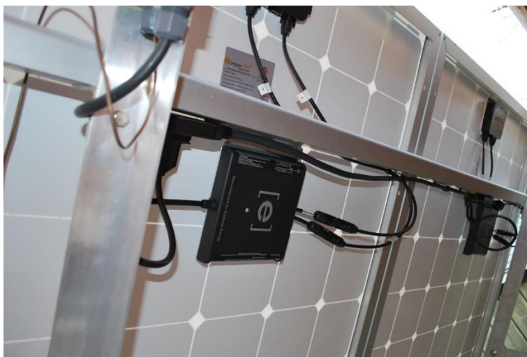
Figura 1.14 - Microinversores instalados nas costas dos módulos solares fotovoltaicos [29].
