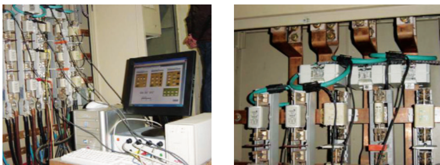
Figura 1 · Monitorizador de qualidade de energia e quadro eléctrico: (a) aspecto geral; (b) sensores de corrente.
