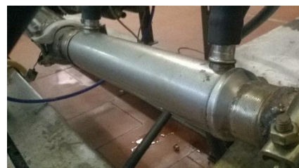
Figura 59 - Permutados de arrefecimento dos gases de escape
