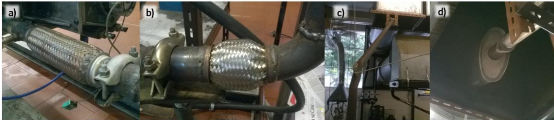
Figura 60 - a) Manga flexível posterior ao coletor de escape; b) Manga flexível pequena; c)Tubo de escape de saída para o exaustor; d) Painel de escape
