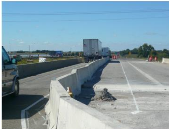
Figura 18 – Obstrução em zonas de obras (Equipamento)
