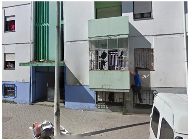
Figura 40 - Vandalismo e lixo acumulado
