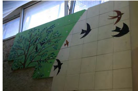
Figura 65: Pormenor do estado da obra Infância . Pormenor do lado esquerdo
