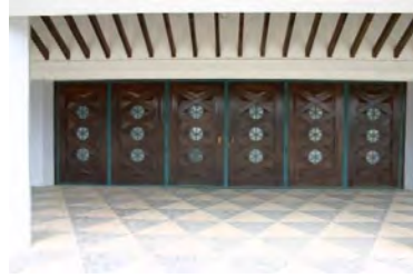
Figura 77: Porta principal com seis secções. Igreja da Sagrada Família em Albarraque, Lisboa.
