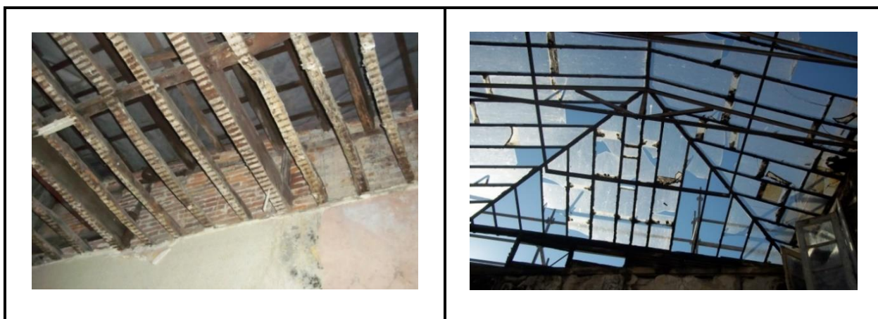
Figura 56 - Fotografia demonstrativa da estrutura de cobertura e do estado da claraboia existente (Autoria própria)
