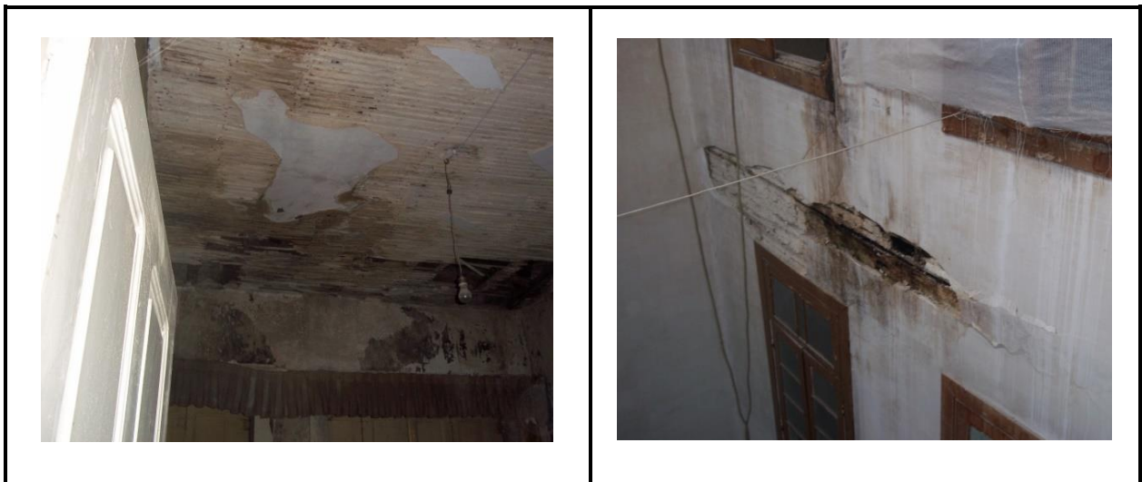
Figura 54 - Fotografias demonstrativas da degradação interior do edifício (Autoria própria)
