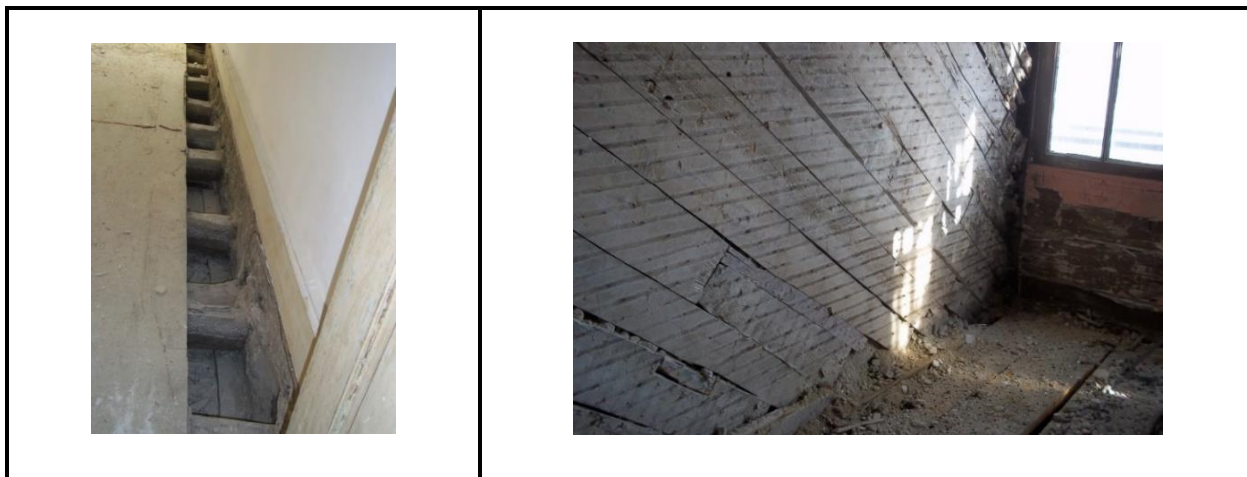
Figura 55 - Fotografia demonstrativa da estrutura de pavimento em madeira e as paredes divisórias em tabique (Autoria própria)
