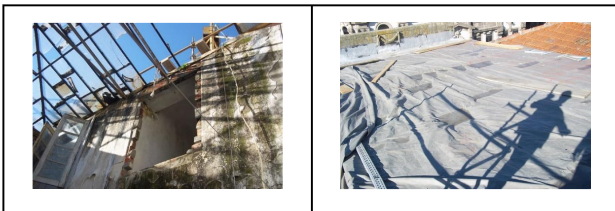
Figura 57 - Fotografia demonstrativa das patologias causadas pela degradação da claraboia e o estado atual da cobertura (Autoria própria)
