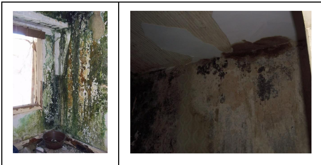
Figura 58 - Fotografia demonstrativa das enormes e evidentes marcas de infiltrações de água (Autoria própria)
