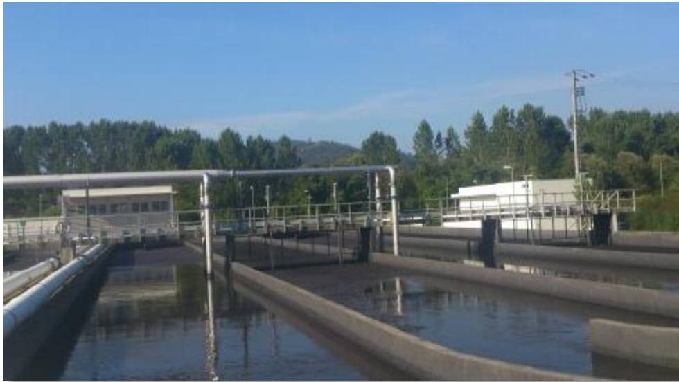
Figura 5. Vala de oxidação da ETAR de Serzedo.
