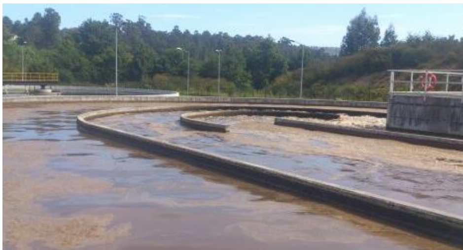
Figura 10. Vala de oxidação da ETAR do Sousa.
