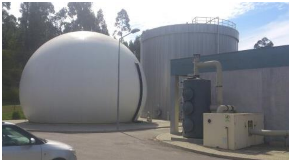
Figura 11. Digestor anaeróbio e gasómetro da ETAR do Sousa.
