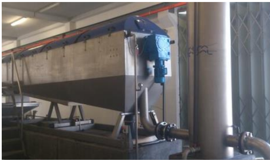
Figura 7. Tambor de espessamento do tratamento de lamas da ETAR de Serzedo.
