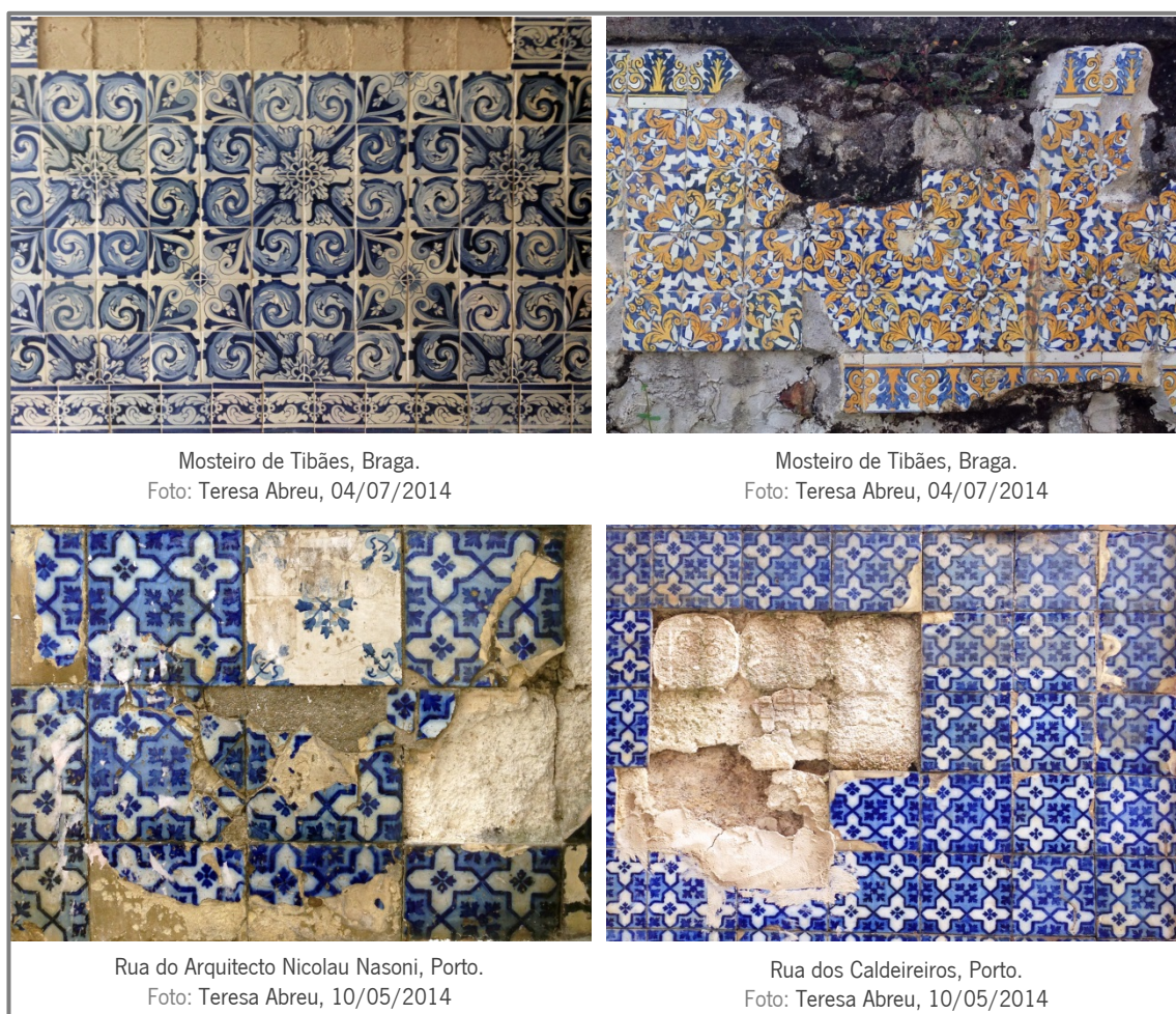
Figura 41 - Primeiros registos fotográficos de fachadas degradadas
