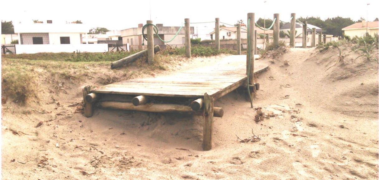
Figura 106. Fotografia de passadiço, após o Inverno.
