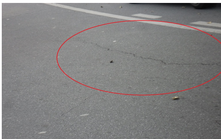
Figura 18 - Fendas isoladas (Rua Cónego Dr. Manuel Faria)
