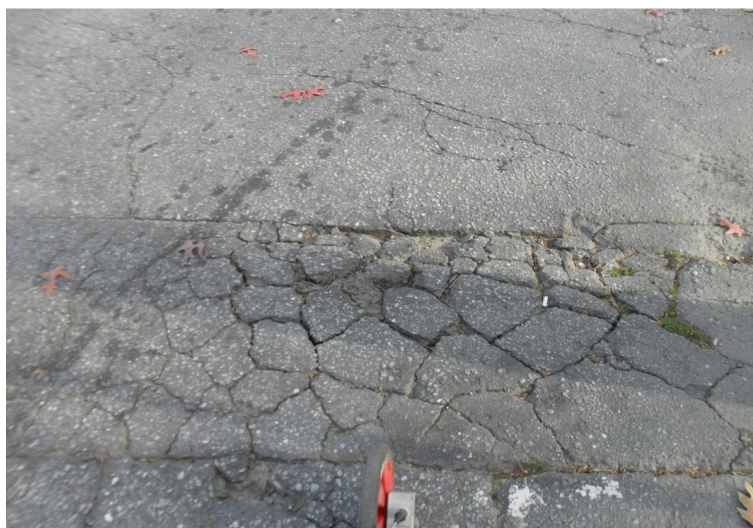
Figura 23 - Degradação da reparação (Rua Associação Artística Vimaranesse).
