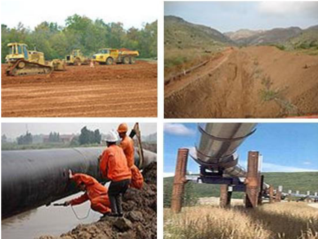
Figura 10 – Seguindo da esquerda para a direita e para baixo: Desbaste do local; Vala para instalação do sistema; Revestimento da tubagem; Tubulações
