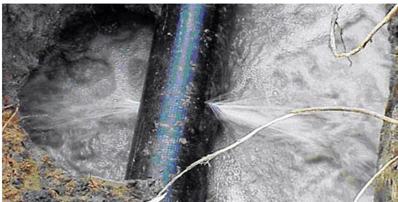
Figura 39 - Fuga de água em tubagem plástica
