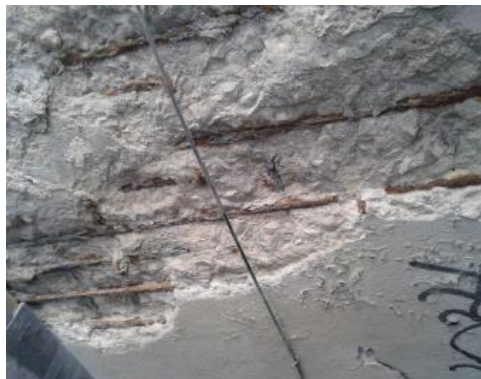
Figura 43 - Exemplo de degradação do betão armado
