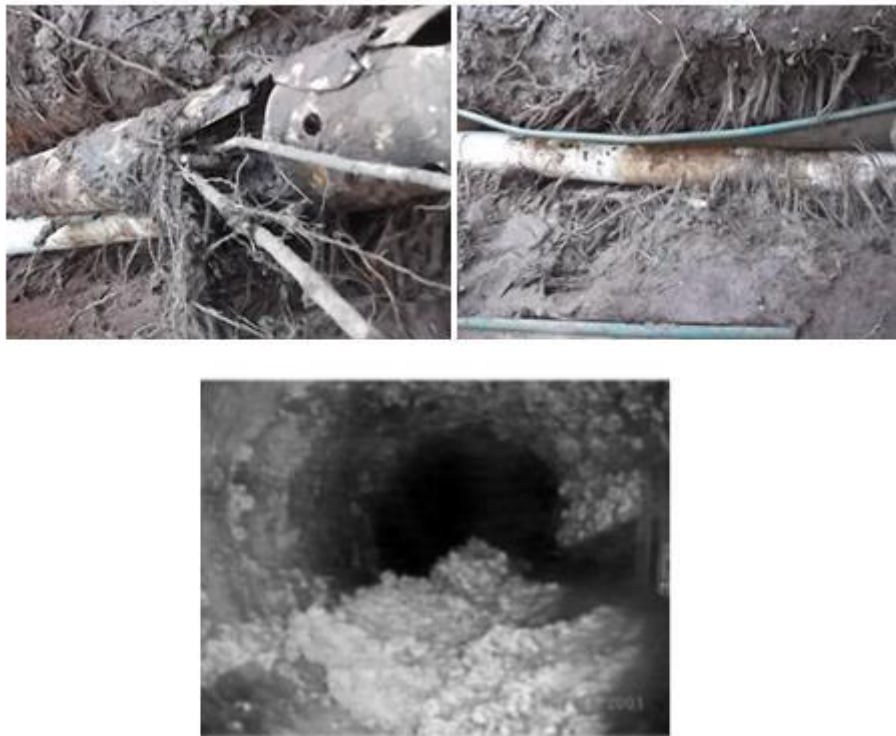
Figura 27 – Da esquerda para a direita: entupimento por raízes; intrusão de raízes entupimento por gordura
