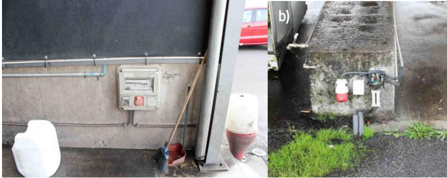
Figura 30 - Pontos elétricos estação de serviço a) quadro elétrico sem proteção b) pontos de ligação e caixa sem tampa
