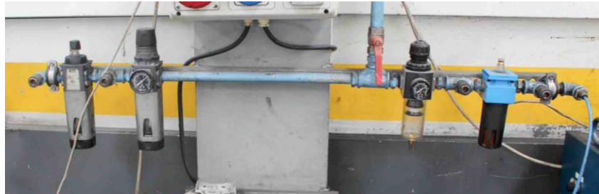
Figura 28 - Ponto de ligação ao sistema de ar comprimido
