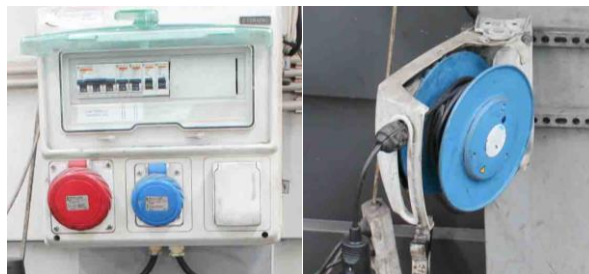
Figura 29 - Equipamentos de ligação elétrica
