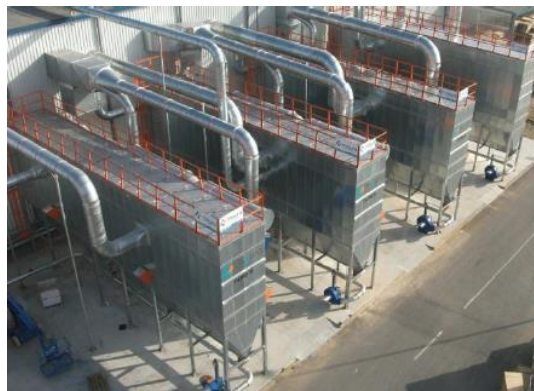
Figura 6.1 - Sistema de ventilação: ventiladores e câmaras de armazenamento (filtros)
