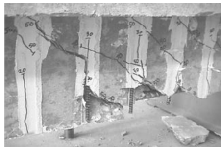
b) Inserção de varões de CFRP em entalhes efetuados no betão de recobrimento (De Lorenzis e Nanni, 2001)
