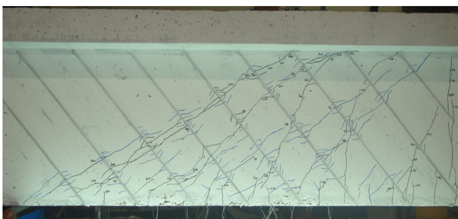
Figura 3.32 - Padrão de fendilhação da viga 3S-9LI-C após o carregamento cíclico.
