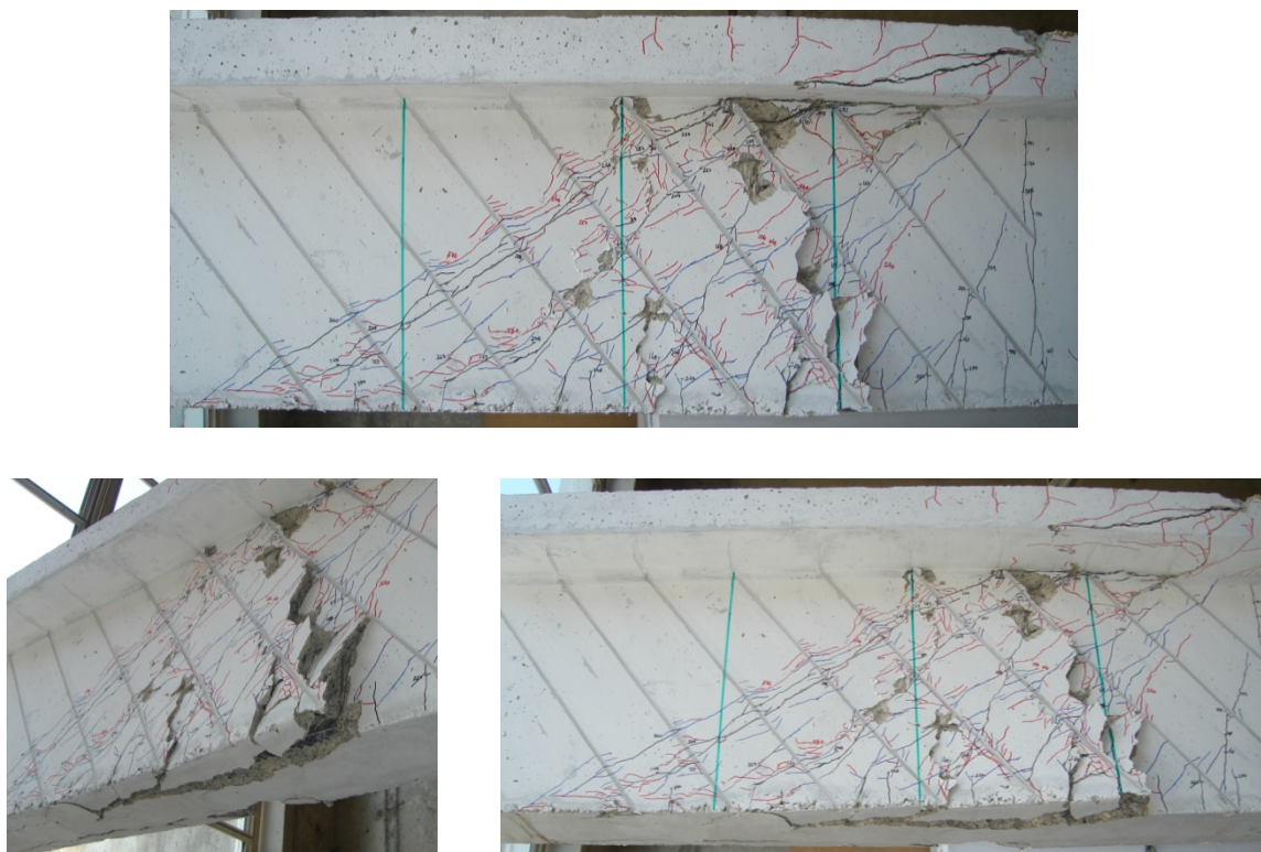
Figura 3.39 - Pormenores do modo de rotura da viga 3S-9LI-C.
