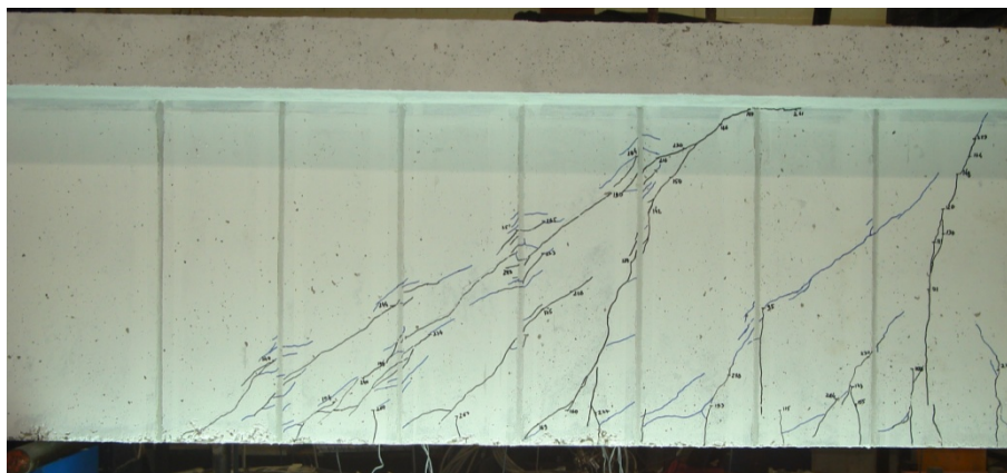
Figura 3.30 - Padrão de fendilhação da viga 3S-7LV-C após o carregamento cíclico.
