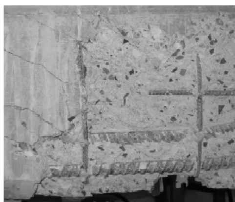
b) Modo de rotura da viga S1-ETS
