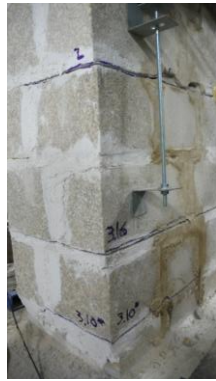
Figura 125 – Aparecimento de fissuras nas duas juntas mais próximas da sapata
