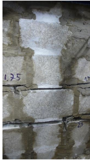
Figura 130 – Fendas abertas da parede StRW.3
