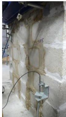
Figura 124 – Aparecimento da primeira fissura
