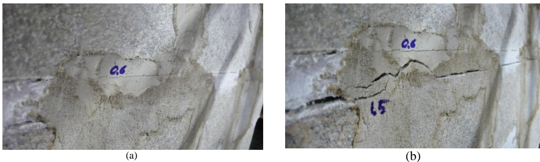
Figura 113 – Fissuras na parede SyRW.1
