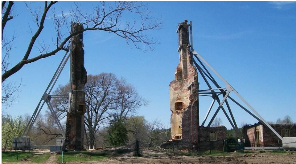
Figura 32 – Técnica de reforço utilizada numa ruína que provoca um impacto visual negativo
