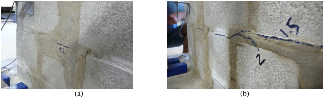
Figura 119 – Fissuras na parede StRW.1
