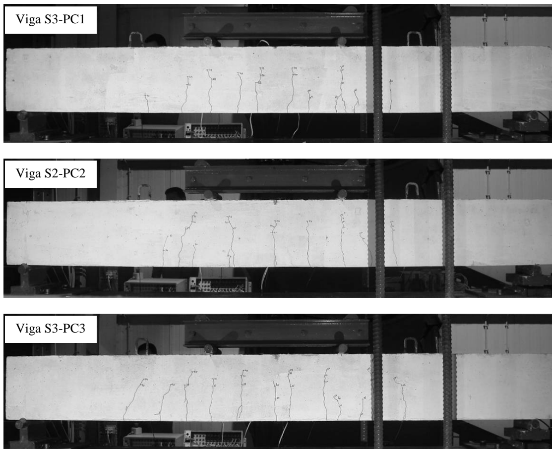
Figura 3.18 - Padrão de fendilhação instalado nas vigas após a realização dos ensaios de pré-fendilhação (ensaio tipo I).
