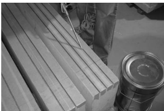
Figura 3.9 - Limpeza dos entalhes das vigas de betão armado, antes da aplicação dos laminados de CFRP.
