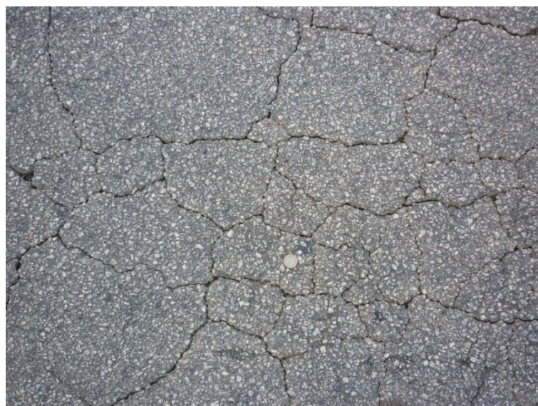
Figura 2.39 – Fendilhamento por fadiga
