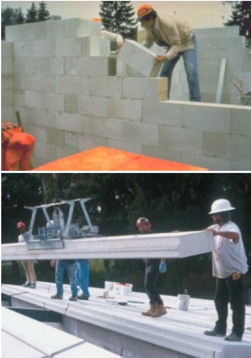
Figura 4.2: Construção com betão celular autoclavado: Em cima assentamento de blocos; em baixo colocação de painel de laje (Mateus, 2004)
