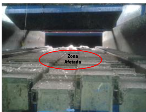
Figura 22 – Vista do interior do separador balístico
