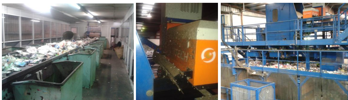
Figura 21 – Falta de limpeza das instalações (exemplos)
