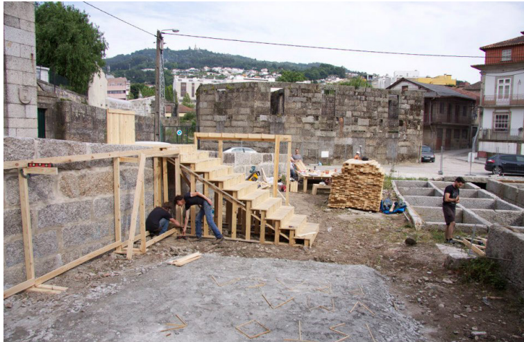
27.1 Início da construção da parede estrutural junto ao muro, onde se pode ver o esqueleto inicial da estrutura.
