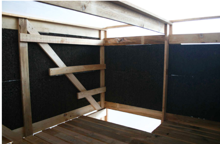
7.4 Interior de um dos quartos já com os painéis de cortiça que funcionam como estruturas divisórias.
