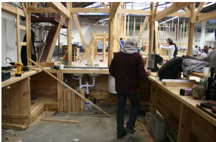
6.2 Vista do interior da cozinha, na fase em que estão a ser feitas as instalações elétricas e a ser colocadas as canalizações.
