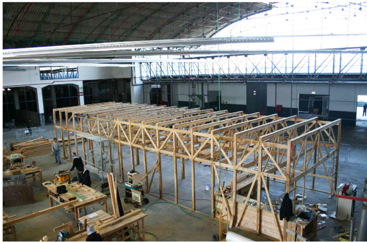
5.2 Fase de construção em que já se pode identificar o esqueleto completo da área de infraestruturas.
