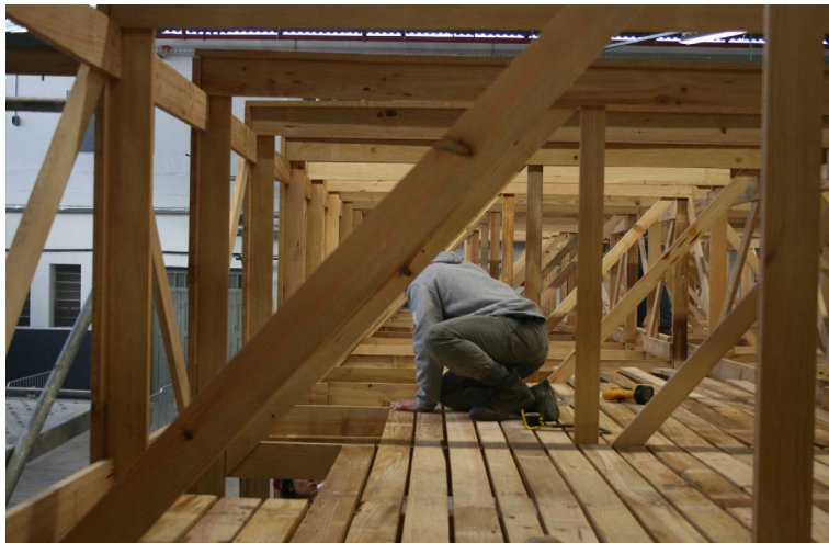
7.2 Interior da estrutura dos quartos na fase em que está ainda a ser colocado o chão.
