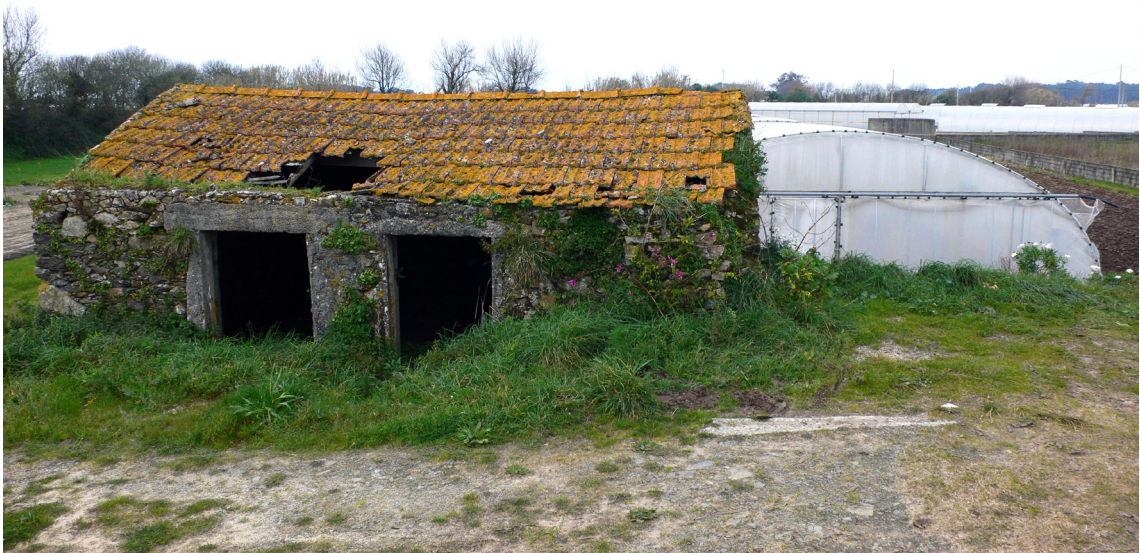
Ruina de um edificio de apoio aos campos agricolas.
