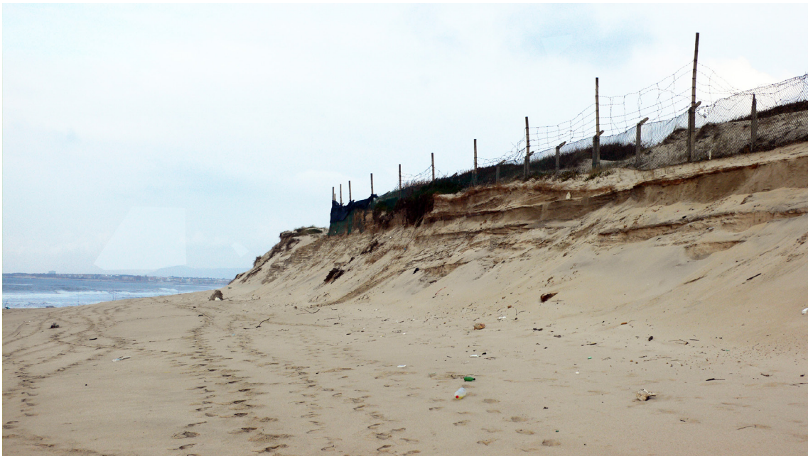
Erosão do cordão dunar pondo em evidência as camadas de sedimentos da sua formação.
