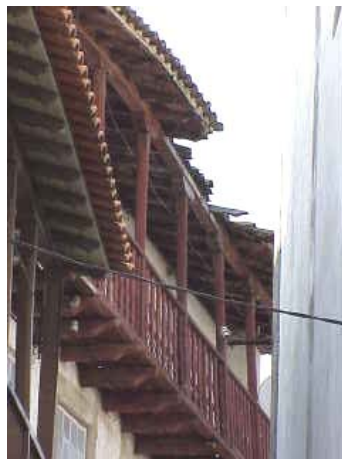
Figura 14 – Deterioração de cobertura
