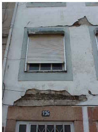
Figura 15 – Destacamento de reboco num edifício
