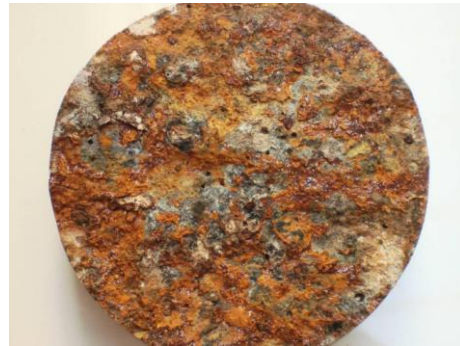
Figura 13. Superfície de fratura após macro-fissuração e destacamento do betão devido à corrosão das fibras de aço no BRFA.
