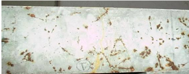
Figura 1. Corrosão superficial em BRFA [7].
