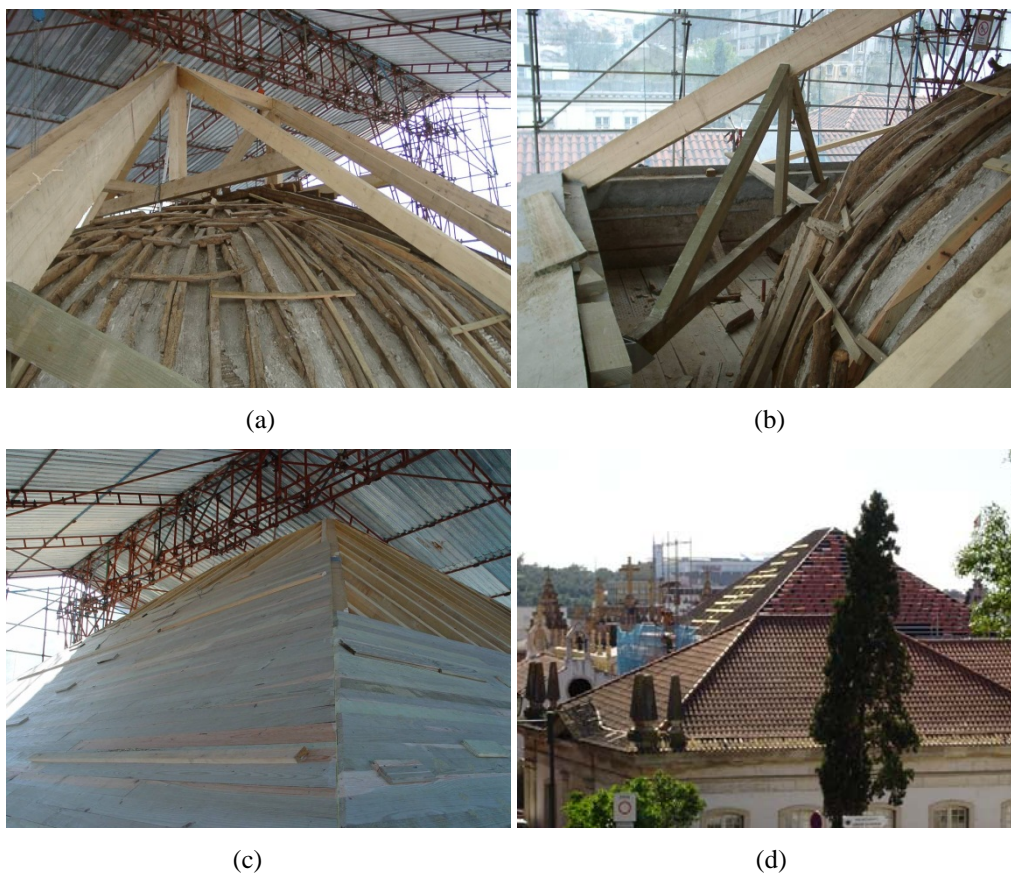
Figura 14 – Detalhes da execução: (a) nova estrutura principal da cobertura; (b) asnas de canto; (c) madres e colocação do forro; (d) cobertura em fase de conclusão
