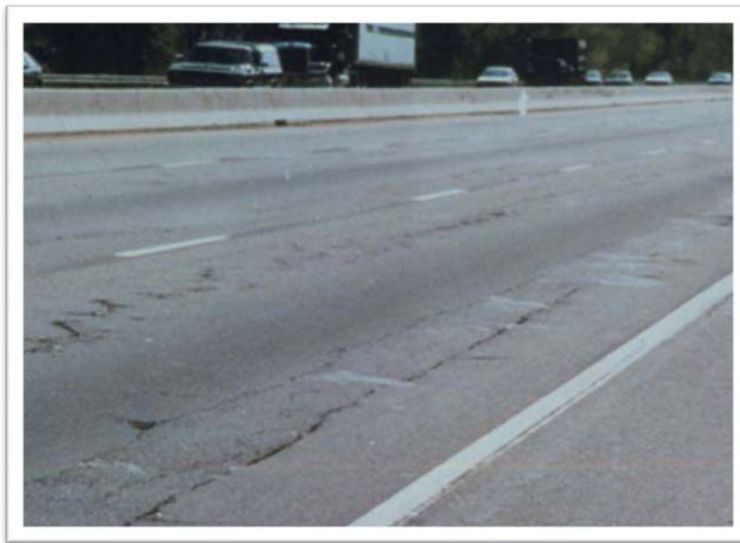
Figura 2-10 - Área trincada nas trilhas de roda
