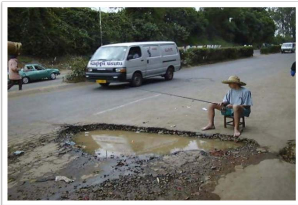
Figura 2-8 – Trincas em pavimentos podem evoluir para buracos
