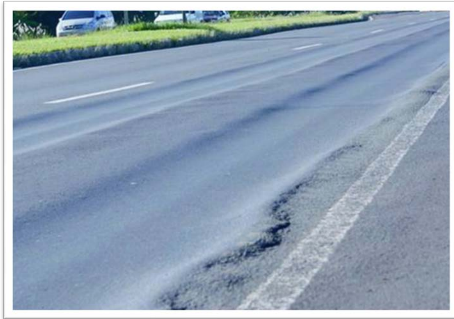
Figura 2-11 - Deformação permanente em rodovia
