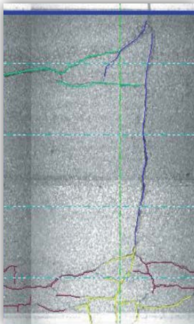
Figura 3-11 - Imagem ortogonal do pavimento com trincas identificadas
