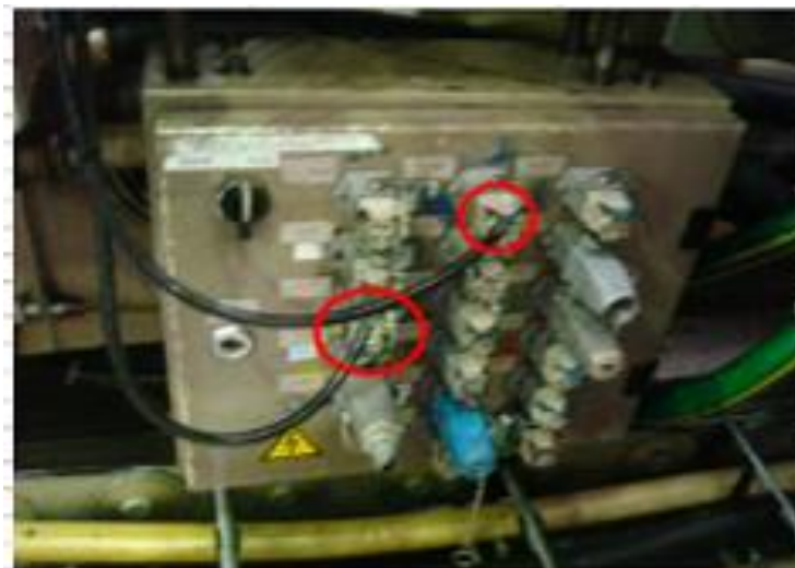
Figura 37 - Ligações de sinais de moldes danificadas
