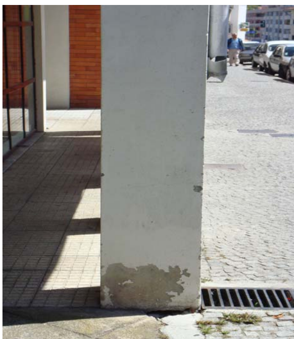
Figura 3.27 – Desprendimento da pintura
