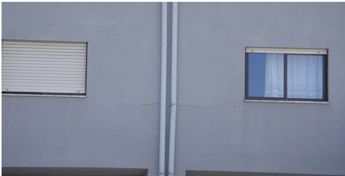
Figura 3.21 – Fissura nos cantos da janela
