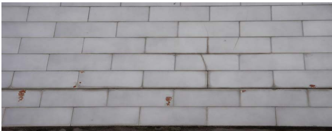
Figura 3.15 – Pormenor de fissuras na varanda
