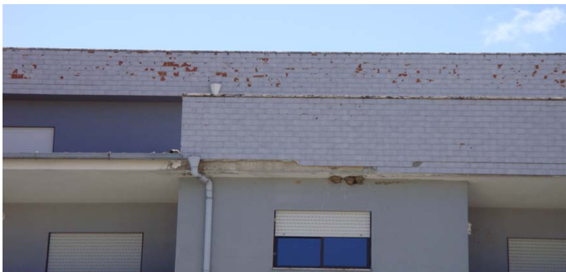
Figura 3.10 – Descolamento na transição laje/alvenaria
