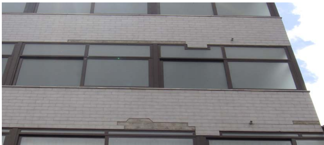
Figura 3.12 - Descolamento transição viga/alvenaria
