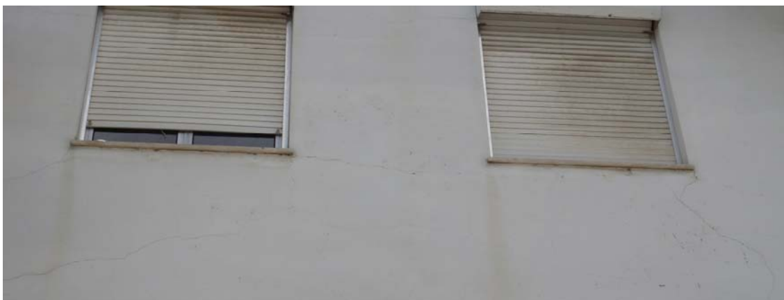
Figura 3.48 – Fissuras ao nível dos vãos
