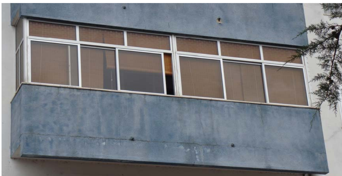
Figura 3.47 – Fissura ao nível da varanda
