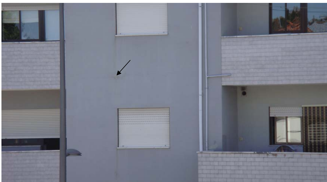
Figura 3.16 – Fissura ao nível da laje de piso
