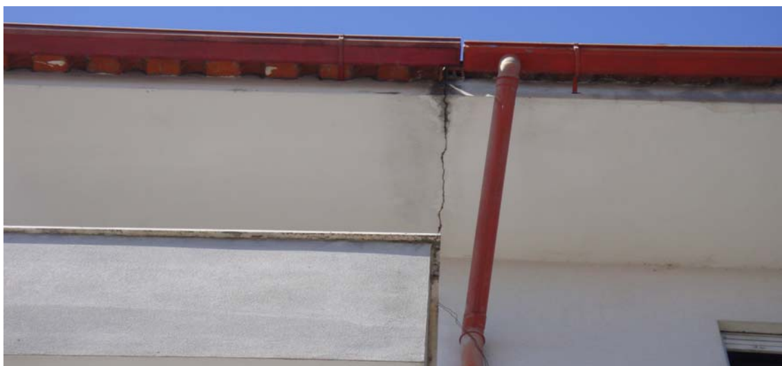
Figura 3.43 – Fissura na cornija
