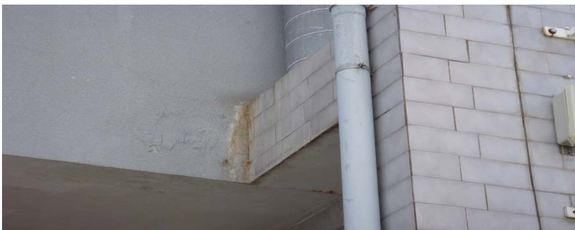
Figura 3.18 – Manchas provenientes da acumulação de sujidades
