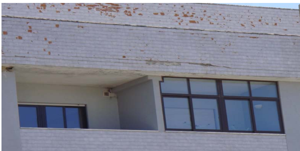
Figura 3.14 – Fissuras na platibanda
