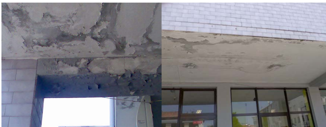
Figura 3.19 – Destacamento da pintura debaixo da varanda
