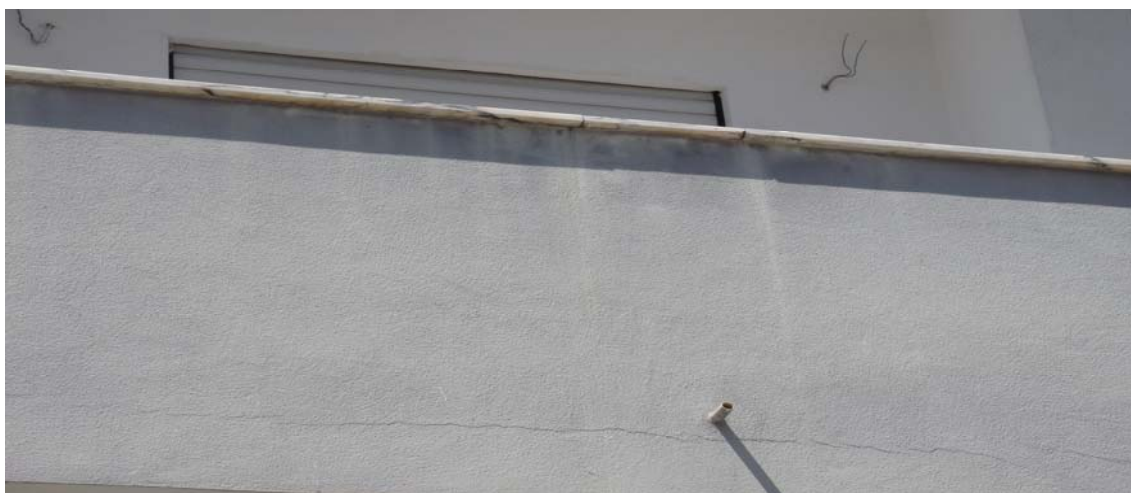
Figura 3.44 – Eflorescências no revestimento de pintura
