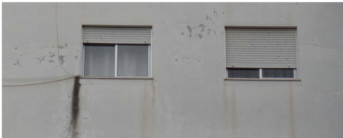
Figura 3.49 – Manchas sob os peitoris
