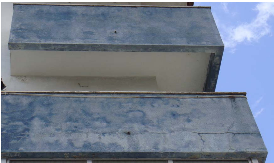
Figura 3.50 – Descoloração da pintura
