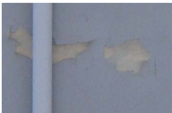
Figura 2.16 – Destacamento da tinta
