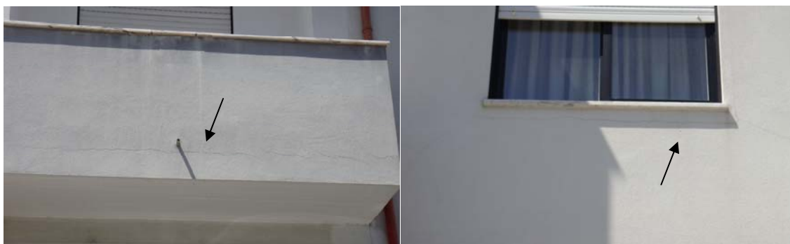
Figura 3.42 – Fissuras ao nível da varanda e da janela
