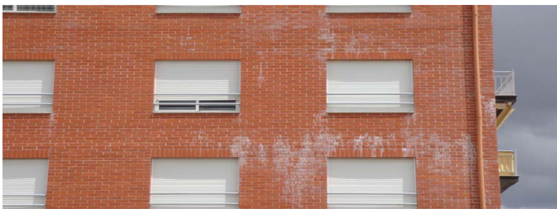
Figura 3.52 – Eflorescências no cerâmico
