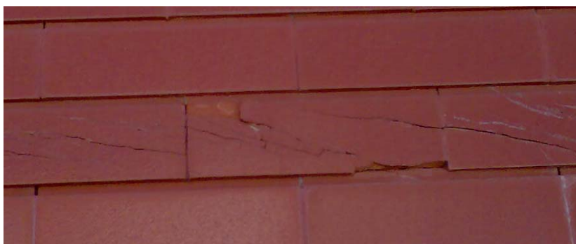
Figura 2.6 – Fissura no cerâmico
