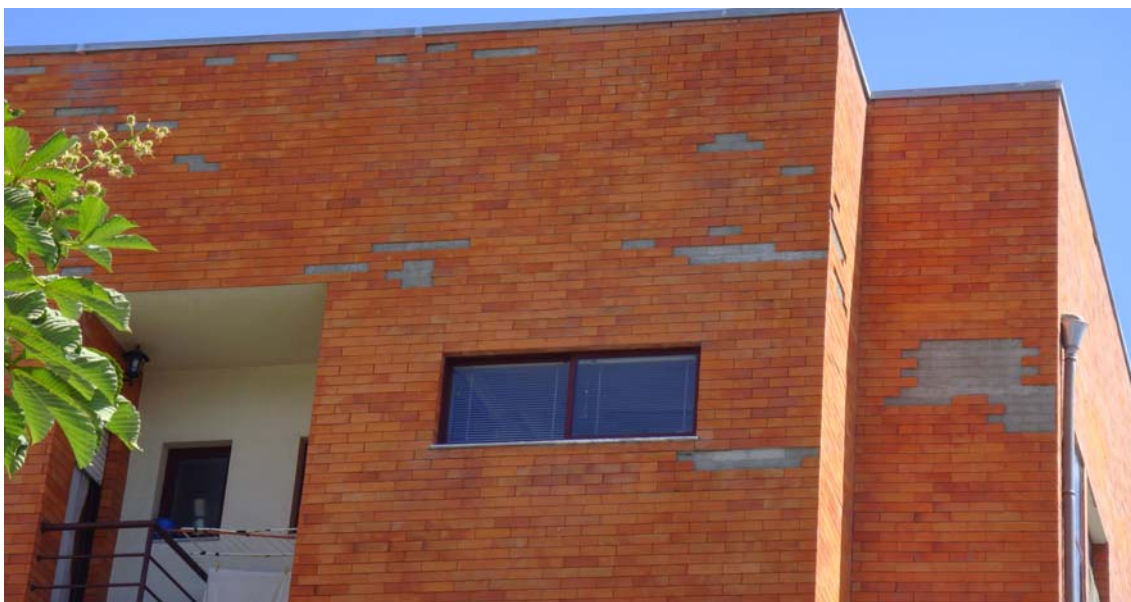
Figura 3.26 – Descolamentos do cerâmico
