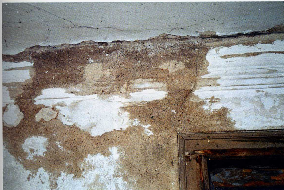
Figura 2: Revestimento de estuque degradado por eflorescências
