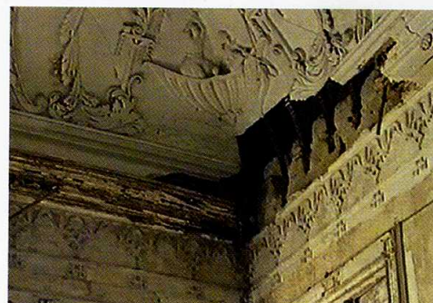
Figura 1: Degradação de revestimentos em estuque devido a deterioração da estrutura da cobertura [4]
