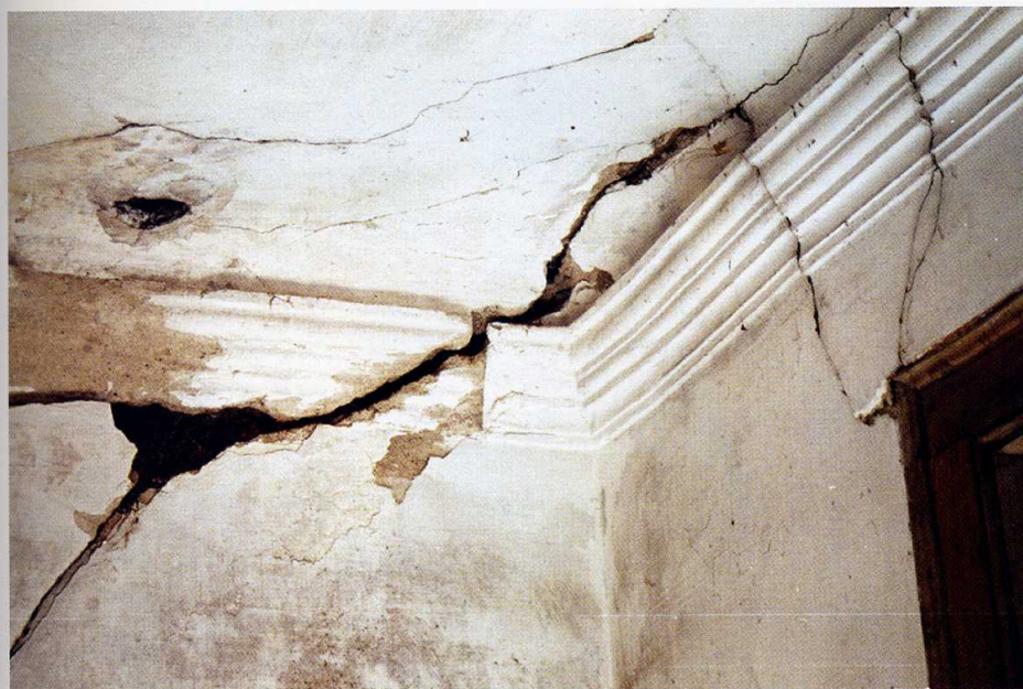
Figura 3: Revestimento de estuque com fissuras de origem estrutural
