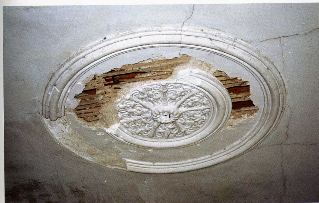
Figura 4: Queda de troços de peça decorativa em gesso
